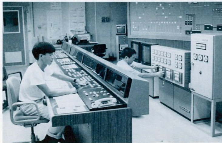
コンピュータを操作し水質管理に努める水道局の職員
