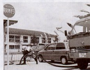
保育園めぐみめぐみとして対策耐震性防火水槽を園庭に設置
