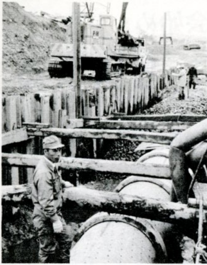
1日当り50,000トンの取水量をふやすため、内径1,200ミリの集水管が延長300メートルにわたって埋設されました。
