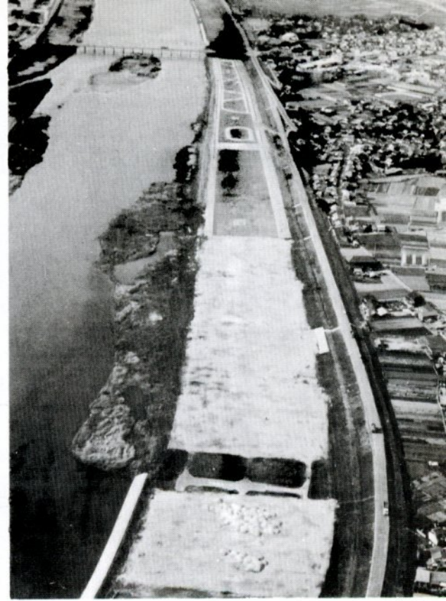
千代川の河川敷に建設している市民スポーツ広場 (上の橋は八千代橋) = 写真は中国航空(株)提供
