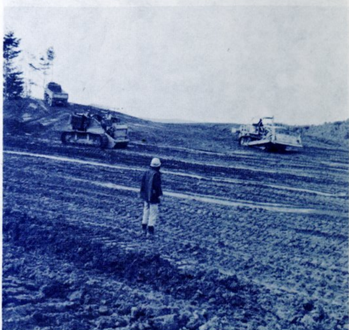
下流の水田に土砂が流失し、被害を出した吉岡地区のゴルフ場造成工事
