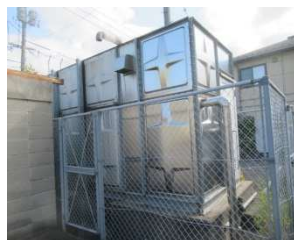
⑩ポンプ室、受水槽
