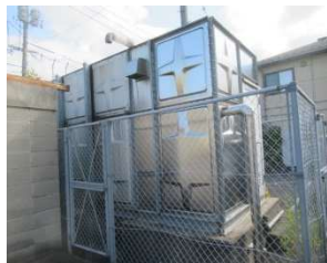
⑩ポンプ室、受水槽
