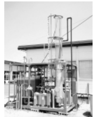
実験用急速ろ過施設(叶水源地内)
