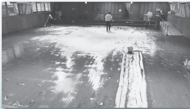
山側からの水が流入して、泥だらけになった記念ホール
