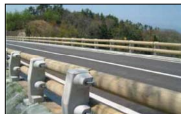
【木製ガードレール】
