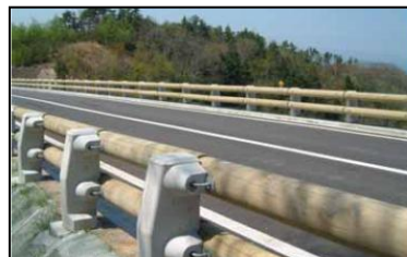
【木製ガードレール】
