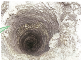
煙突内部のアスベスト断熱材
