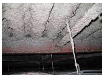
天井裏の吹付け材
