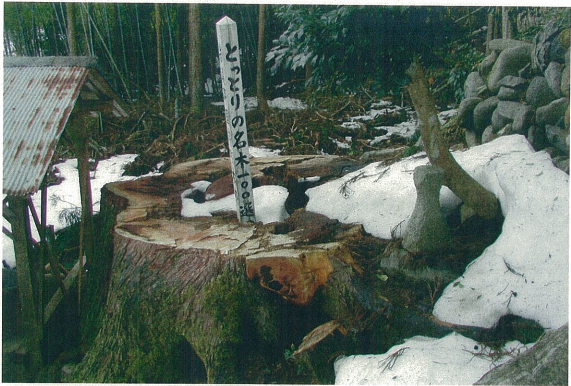
空洞化した伐採断面（伐採後）
