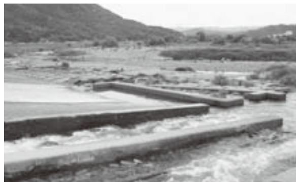
千代川大口堰に設置されている魚道
