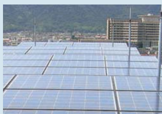
太陽光発電システム
