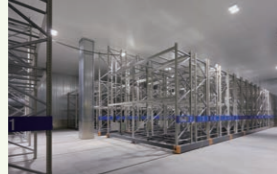
冷蔵・冷凍・常温の3温度帯を備える物流倉庫
