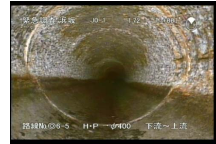
鉄筋コンクリート管腐食状況(昭和50年布設)
