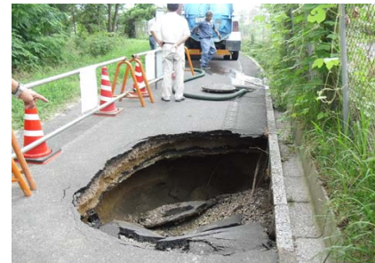
鉄筋コンクリート管の腐食による陥没事故
