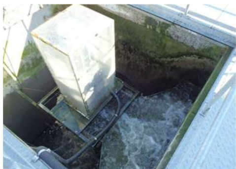
図6 小水力発電機
