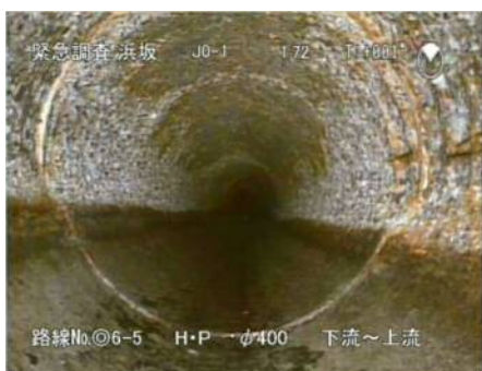
図 22 鉄筋コンクリート管の腐食状況（S50年敷設）
