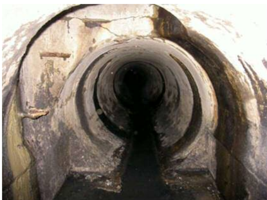
図 29 老朽下水管の状況
