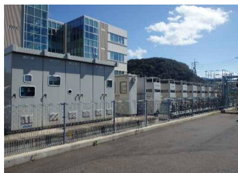
図7 消化ガス発電設備
