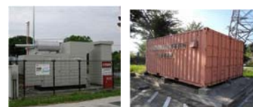
非常用発電機
