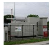
非常用発電機
