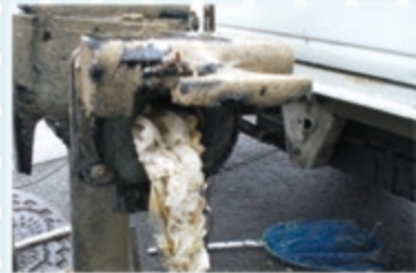
布やウエットティッシュで詰まったポンプ。修理や清掃には、多くの人手と費用がかかります。
