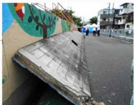
ブロック塀倒壊事故状況：高槻市報告書資料
