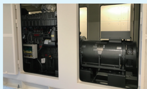
屋上に設置した非常用発電機
