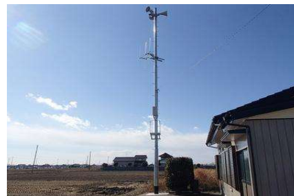
写真31: 防災行政無線
