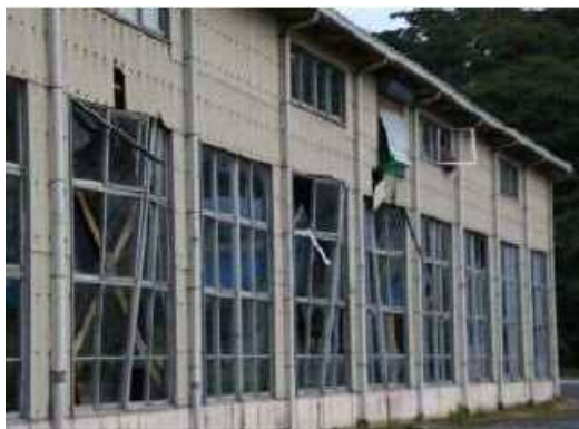
外壁の傾斜、破損
