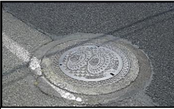
写真1 マンホールの蓋
