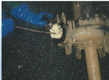
油が固まって詰まった下水管
