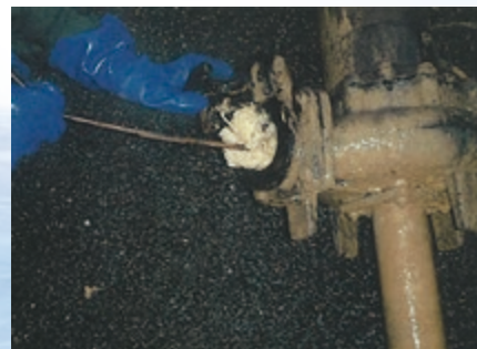
油が固まって詰まった下水管
