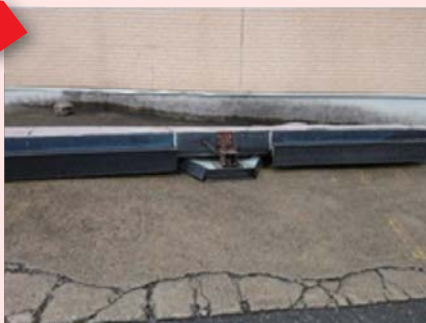
落下した欄間看板
