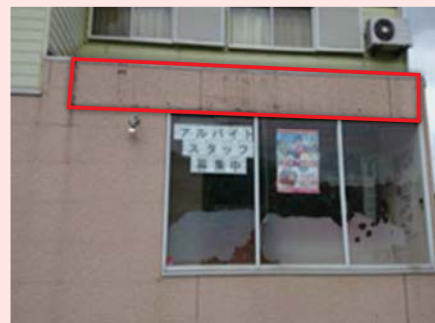
落下した後の壁面
