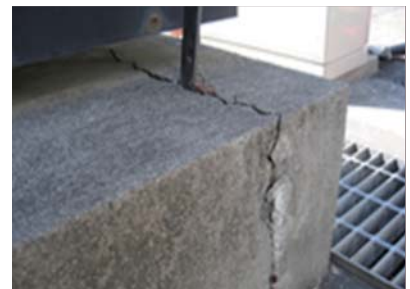
看板基礎のひび割れ
