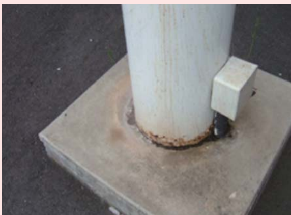
ポールの根元にサビが発生
