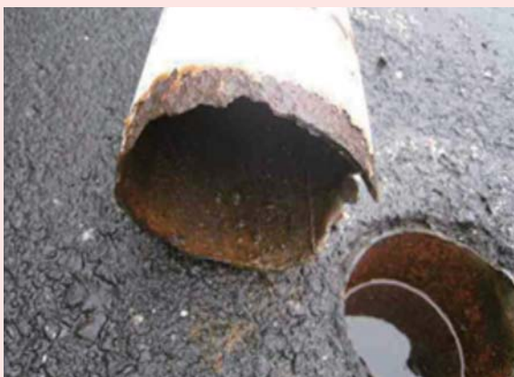
ポールの根腐れによる倒壊
