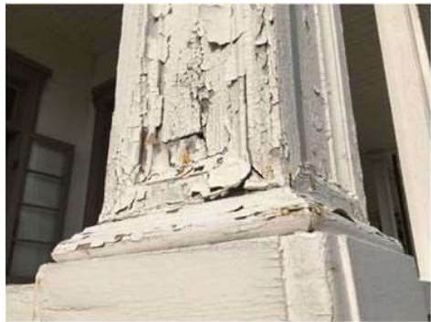
破損個所の一例
