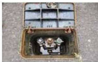
応急給水栓 (内部)
