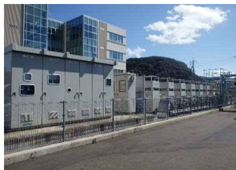
図7 消化ガス発電設備
