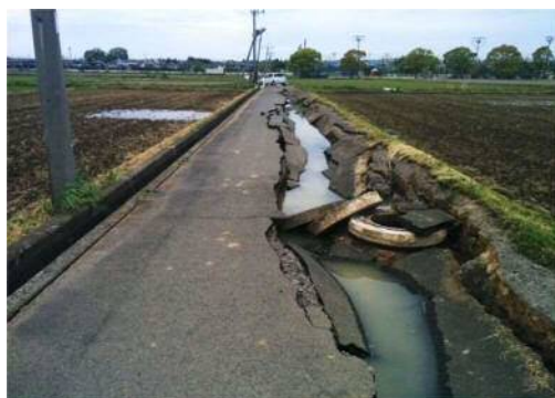
図 19 汚水幹線の路面陥没 (出所：国土技術政策総合研究所資料)
