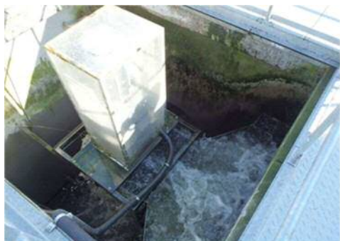
図6 小水力発電機
