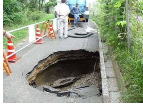
図 23 鉄筋コンクリート管の腐食による道路陥没
