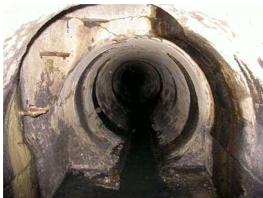
図 29 老朽下水管の状況
