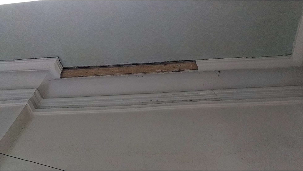
事務室崩落箇所
