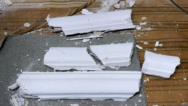
崩落した部材
