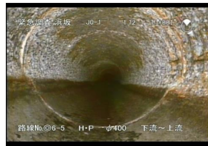
鉄筋コンクリート管腐食状況(昭和50年布設)
