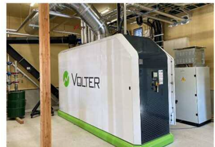
熱電併給設備導入 熱も電力も産み出し有効活用
