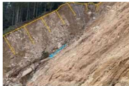
土砂流出発生源(北村地区)
