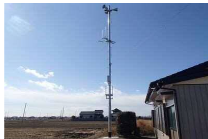
写真36: 防災行政無線
