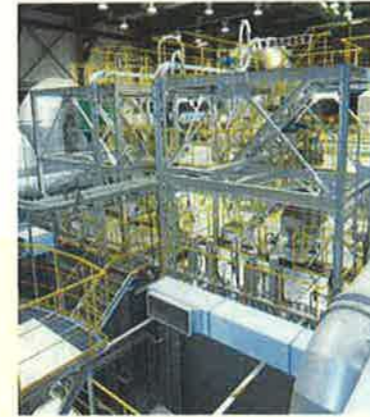
活性炭吸着塔 16
