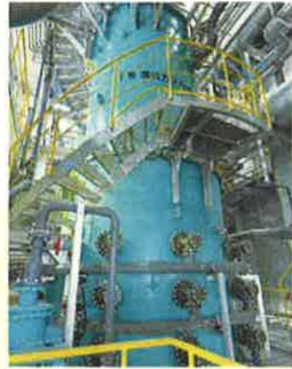
湿式ガス洗浄塔 13
