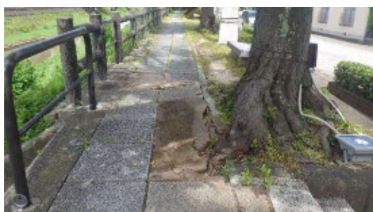
コンクリートブロックの浮き上がり
