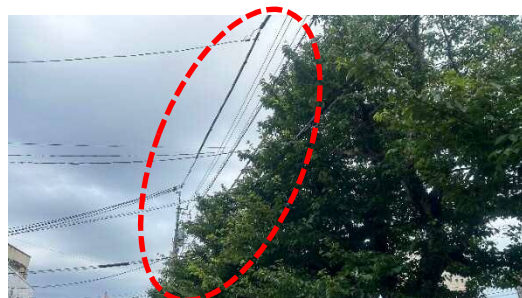
枝の電線干渉状況
