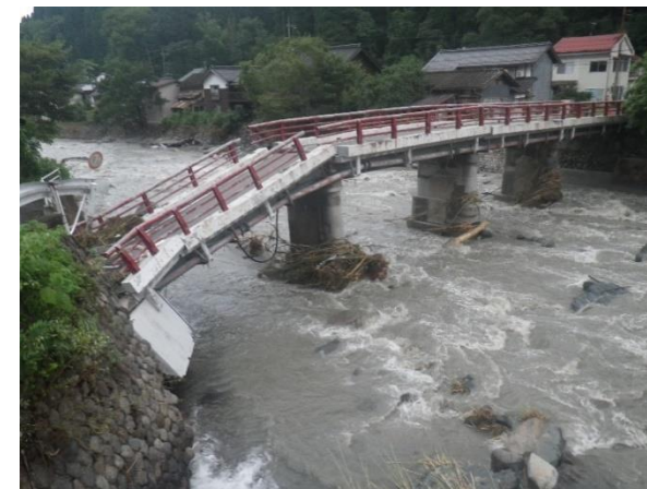
鳥取市佐治町高山橋(橋梁の崩落)
