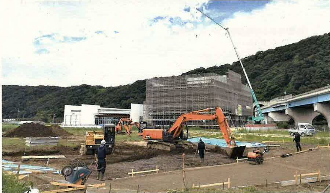
展示ガイダンス施設の工事状況（左：ガイダンス棟 右：重要文化財棟）
