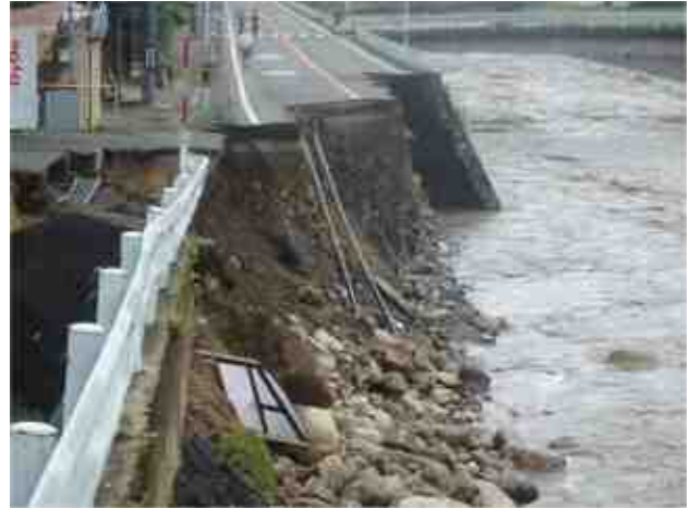
下水道管破損 別府国道 R5. 8. 16
