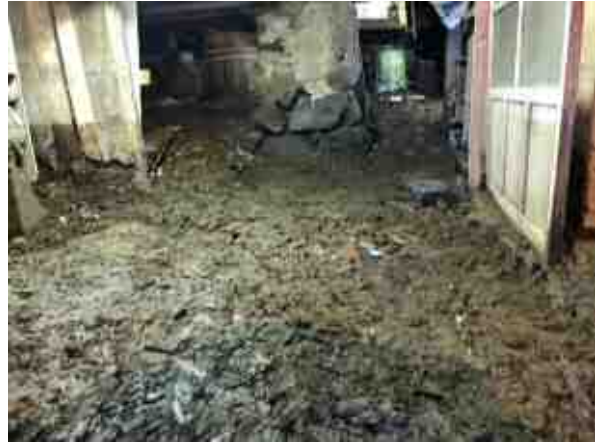
加瀬木 住宅床下浸水 R5. 8. 26
