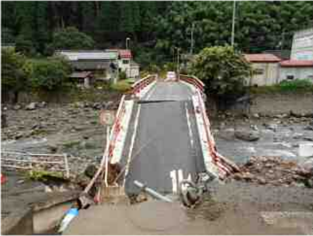
上下水道破損 高山橋市道 R5. 8. 16
