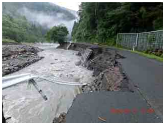
余戸和田河原付近 R5. 8. 17 道路崩壊 国道 482 崩落
