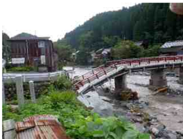
高山橋橋げた落下市道 R5. 8. 16
