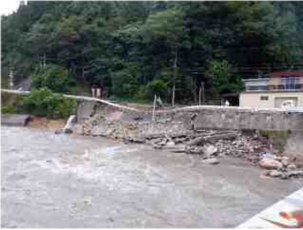
古市上八幡坂付近 R5. 8. 16 佐治川の氾濫により道路崩落
