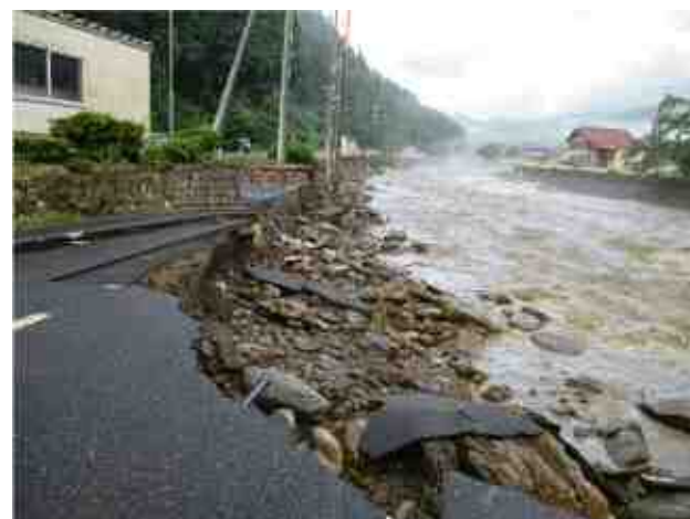
佐治コミュニティセンター付近 R5. 8. 16 佐治川の氾濫により道路崩落
