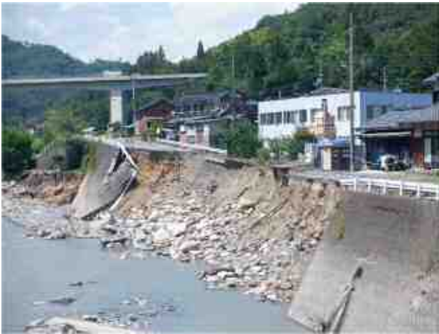
別府付近 R5. 8. 16 佐治川の氾濫により道路崩壊
