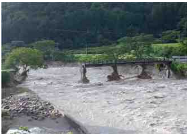
旧刈地橋橋げた崩落 R5. 8. 16
