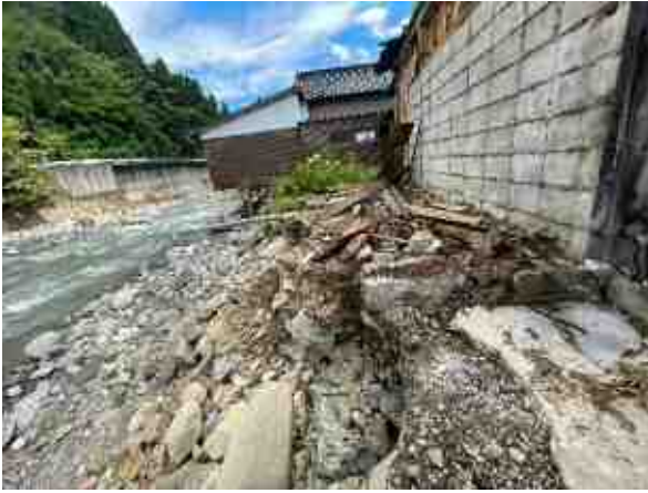
加瀬木 倉庫流失 R5. 8. 24
