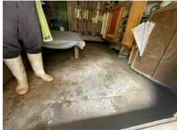
津無 住宅床下浸水 R5. 8. 24
